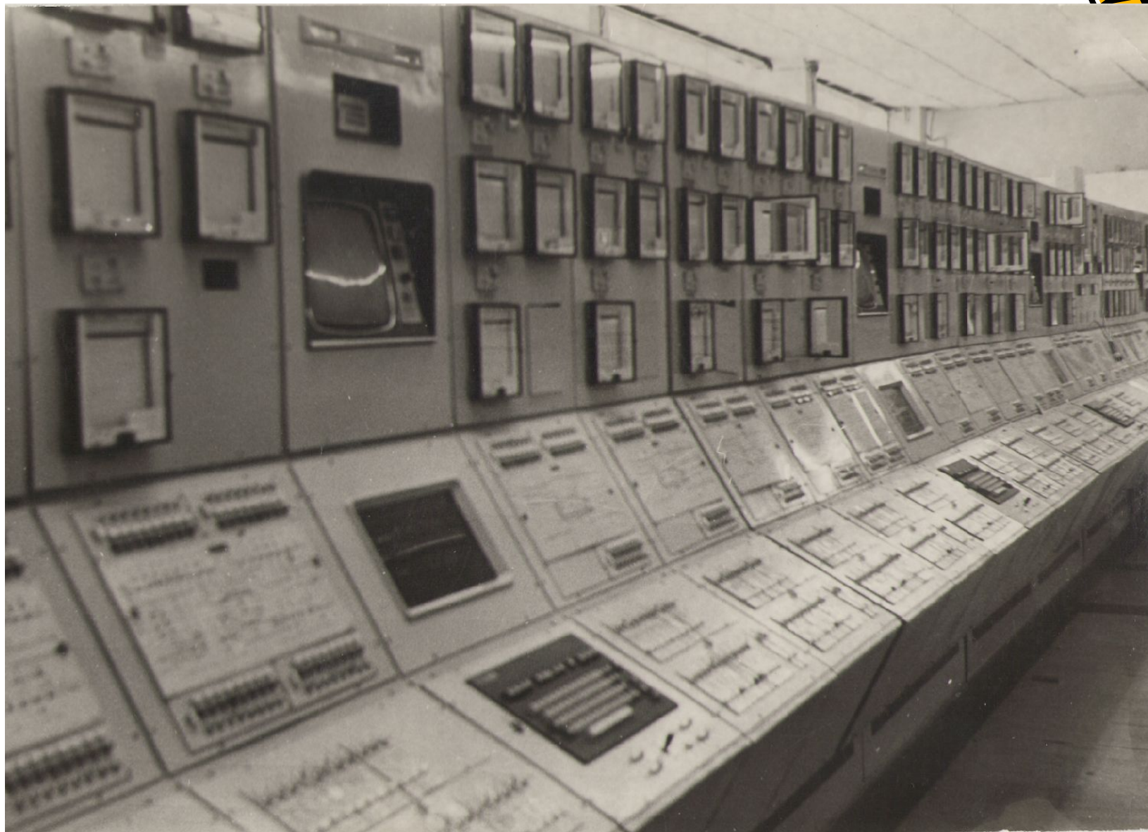
Центральный пульт управления (ЦПУ)
