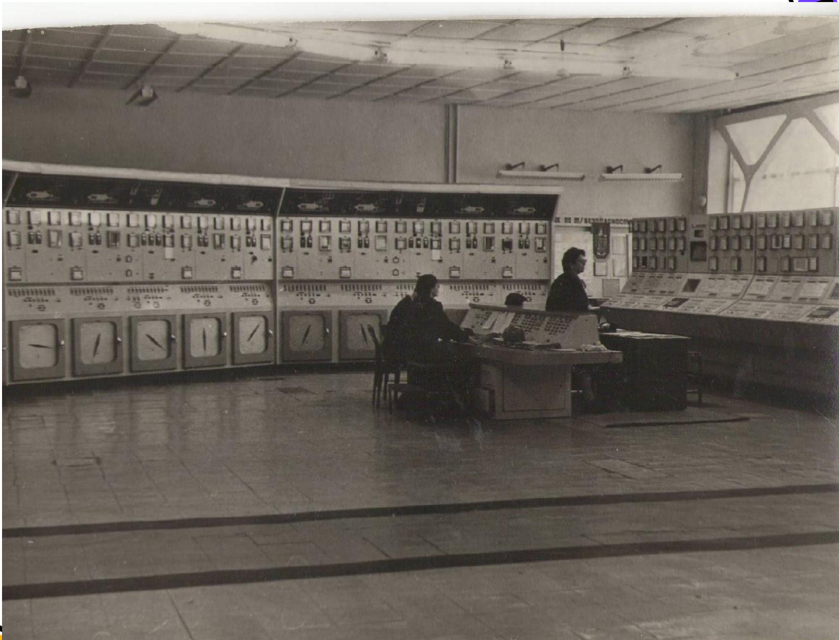
Центральный пульт управления (ЦПУ)
