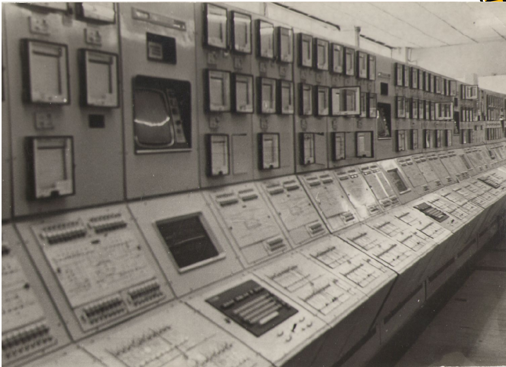
Центральный пульт управления (ЦПУ)
