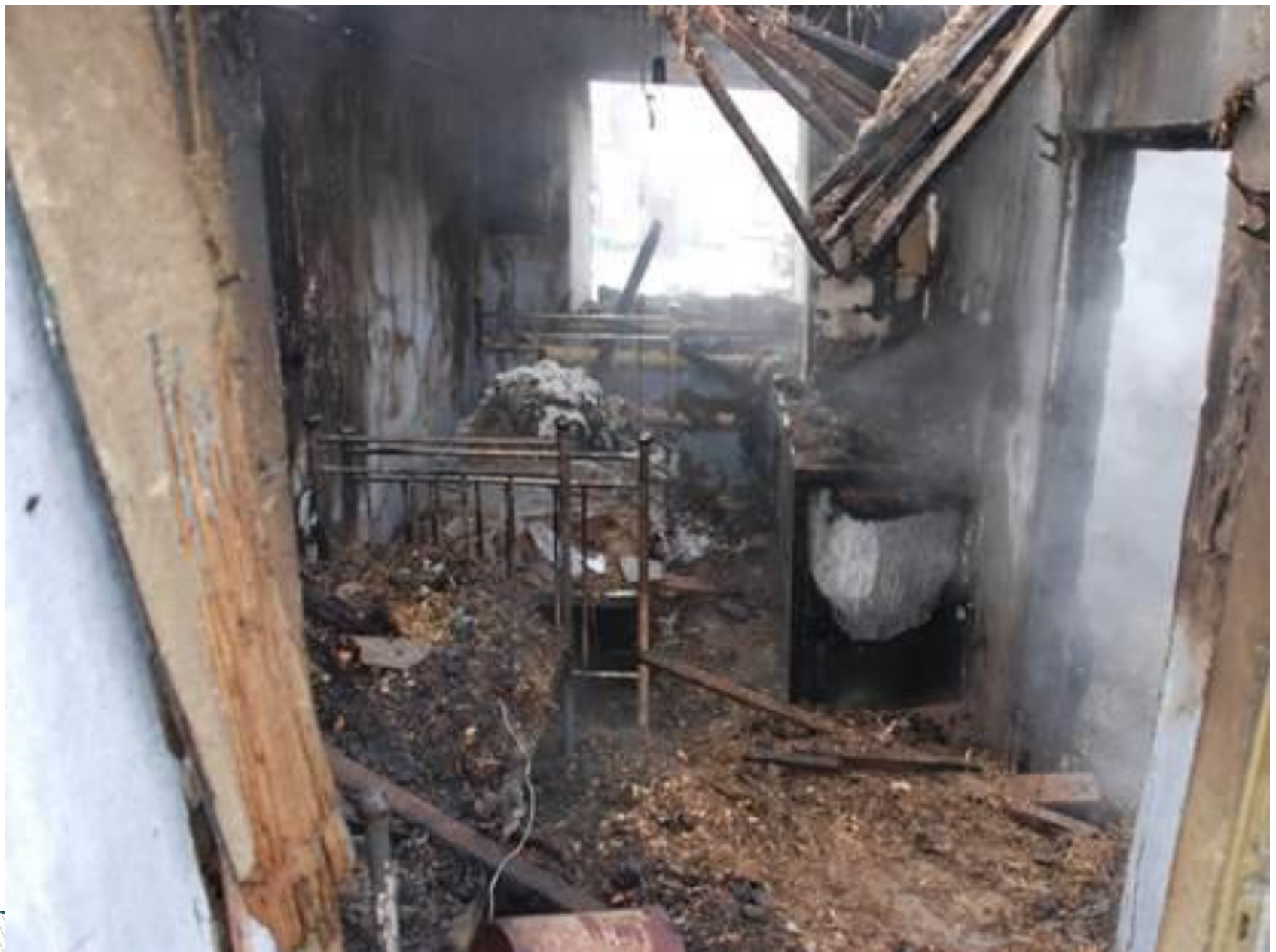
Последствия взрыва бытового газа
