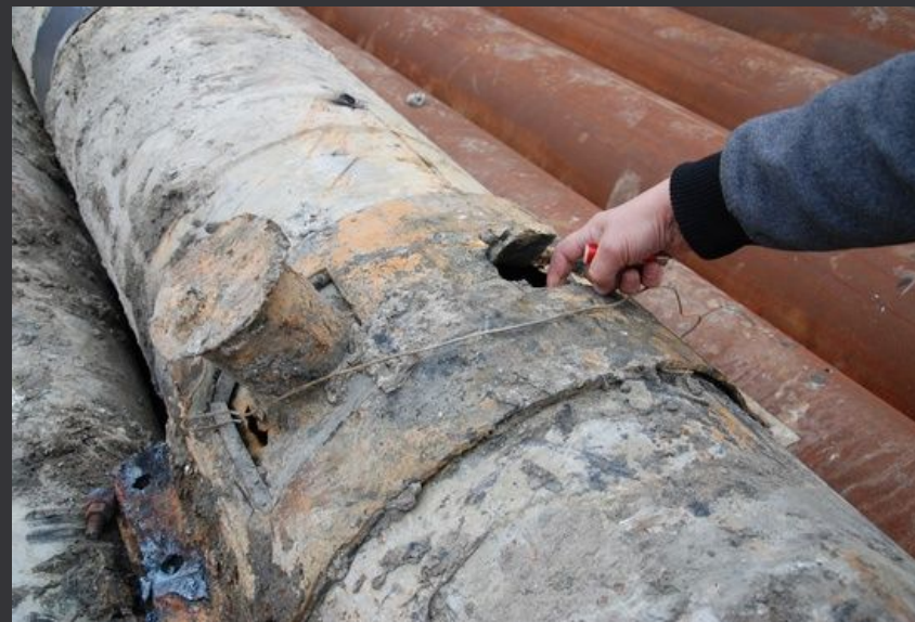
Разрушение трубопровода водовода
