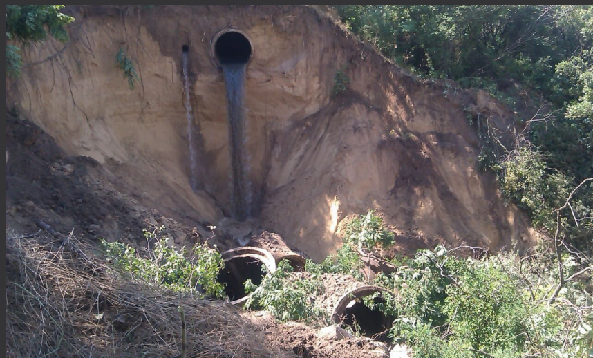
Разрушение трубопровода канализации
