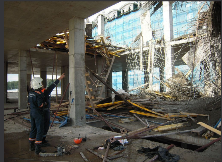
Обрушение здания на Урале
