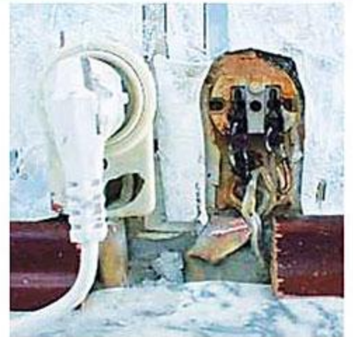
Пошкоджені електричні розетки
