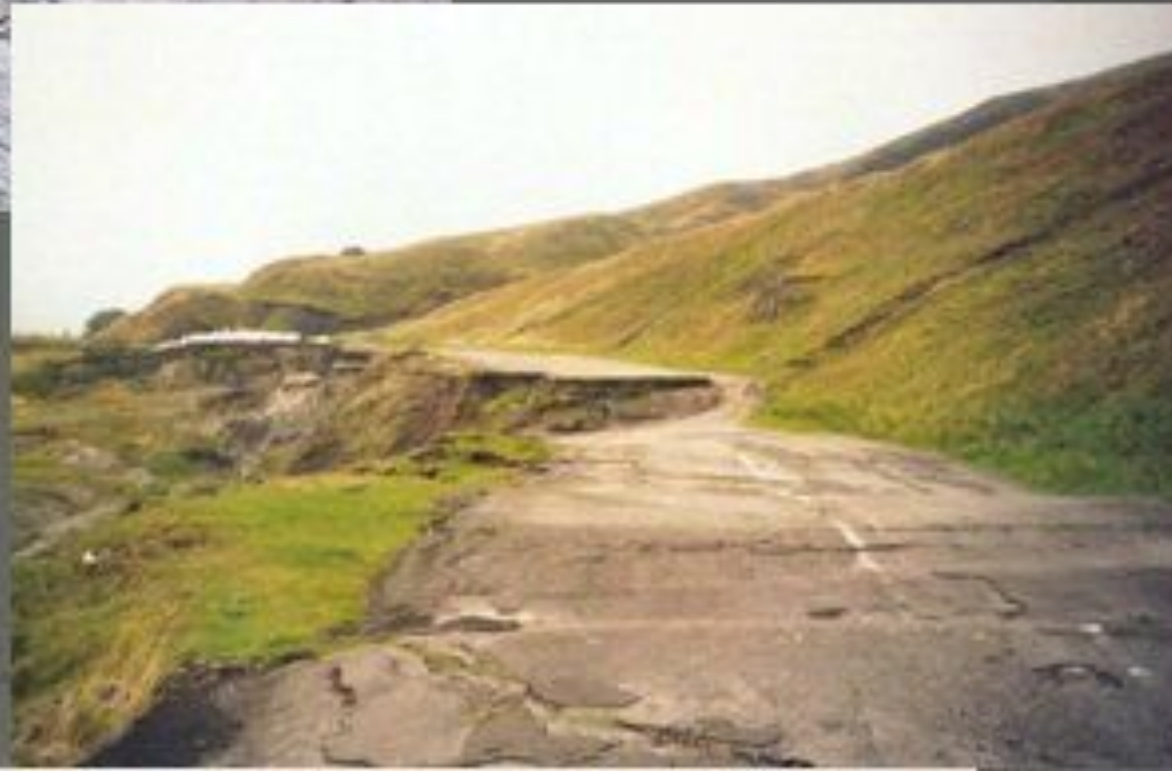
Обвал на дорозі.
