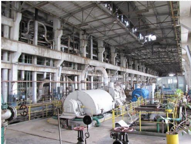
Розділ ТЕЦ, Турбінне відділення
