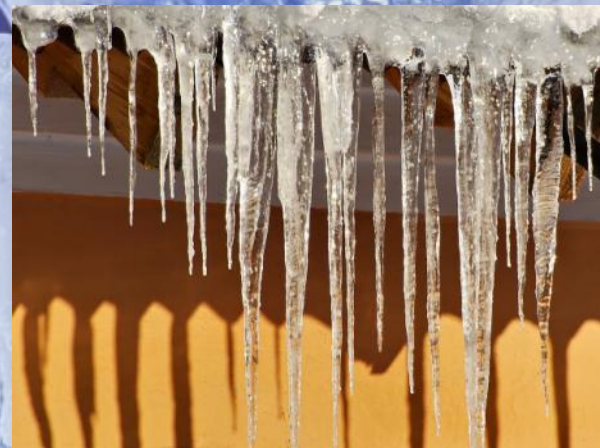
Сосульки на крыше
