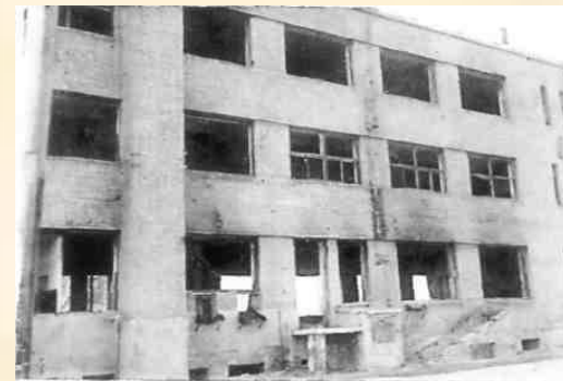
Развалины на месте здания почты
