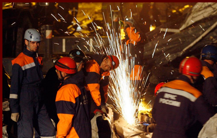
Авария на Саяно – Шушенской ГЭС
