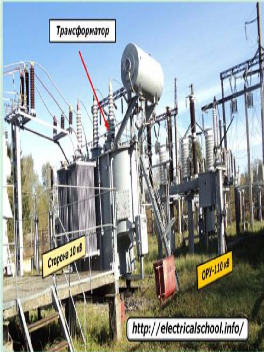
Силовой трансформатор на подстанции 110/10 кВ
