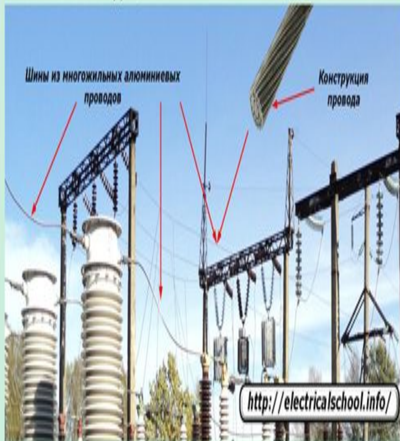
Конструкция шин на ОРУ-110 кВ
