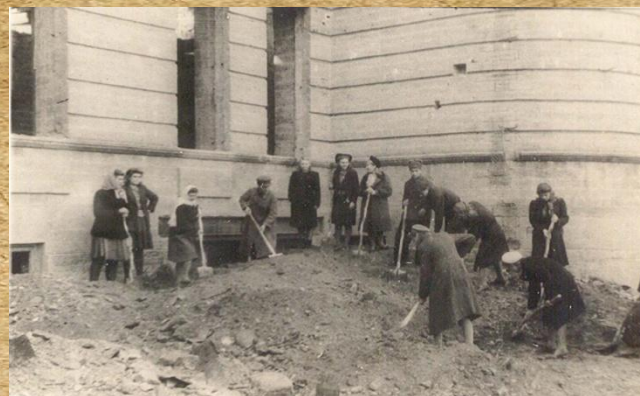
Один из разрушенных корпусов института г. Ставрополь
