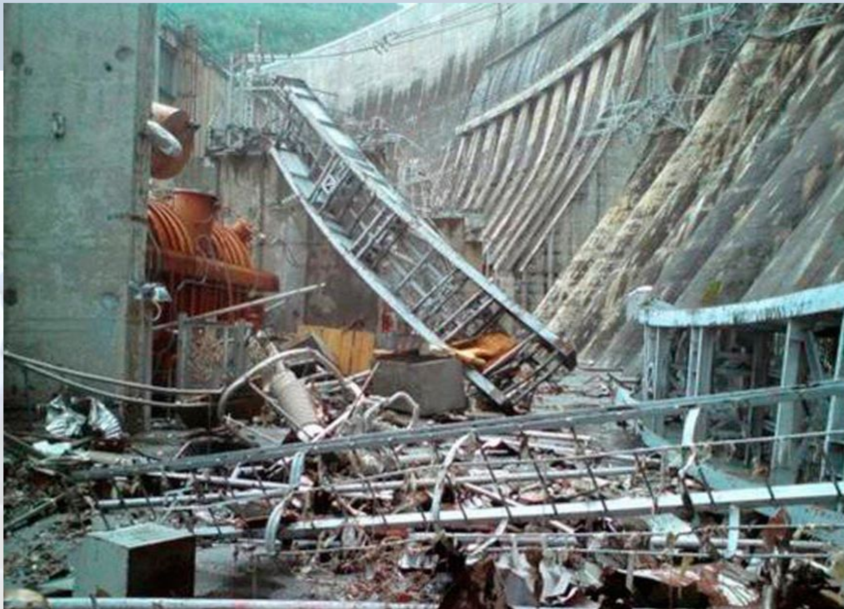
Последствия катастрофы на Саяно-Шушенской ГЭС, август 2009 г.
