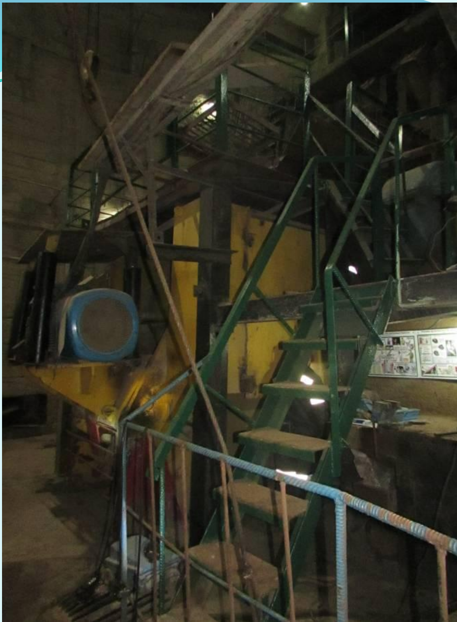
Маслостанция дробилки Nordberg C-125
