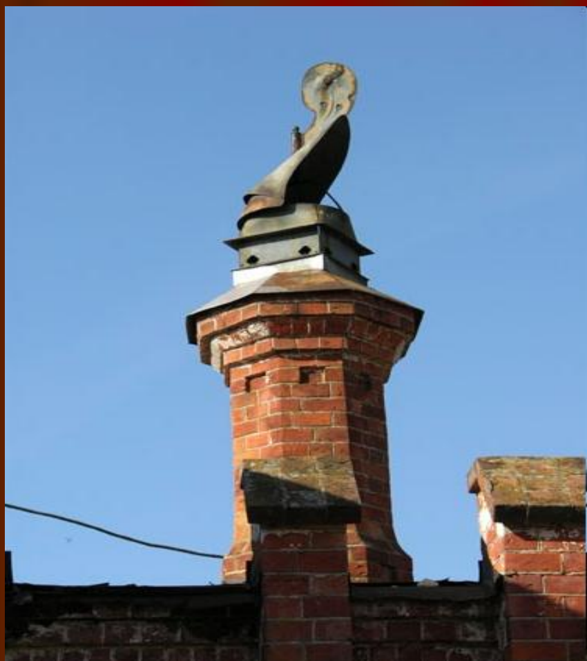
§. Труба с дефлектором-флюгером над хозяйственным корпусом
