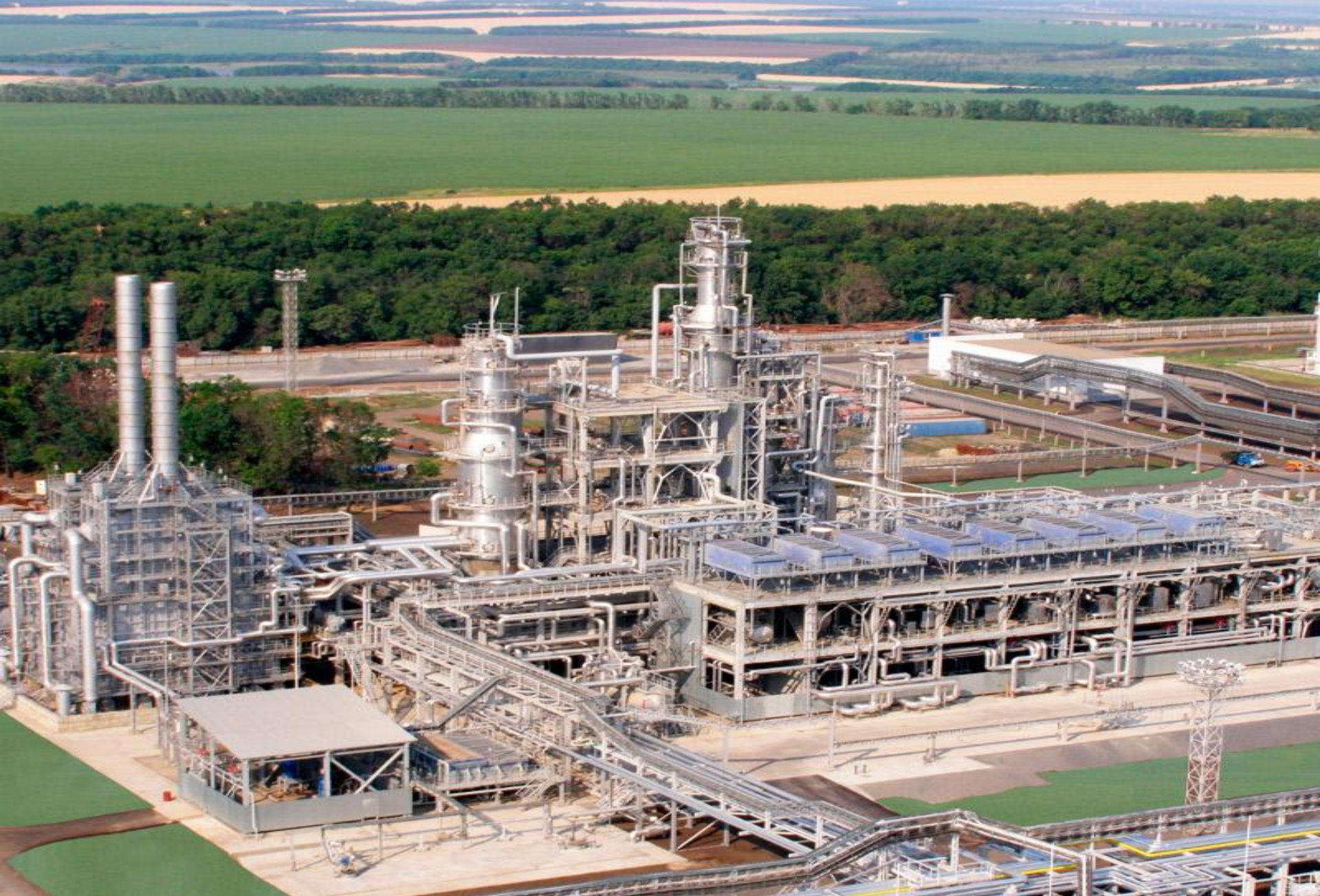
Общий вид установки первичной переработки нефти
