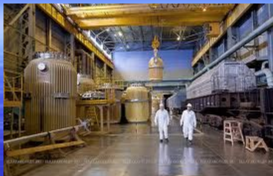
предприятия по переработке или изготовлению ядерного топлива
