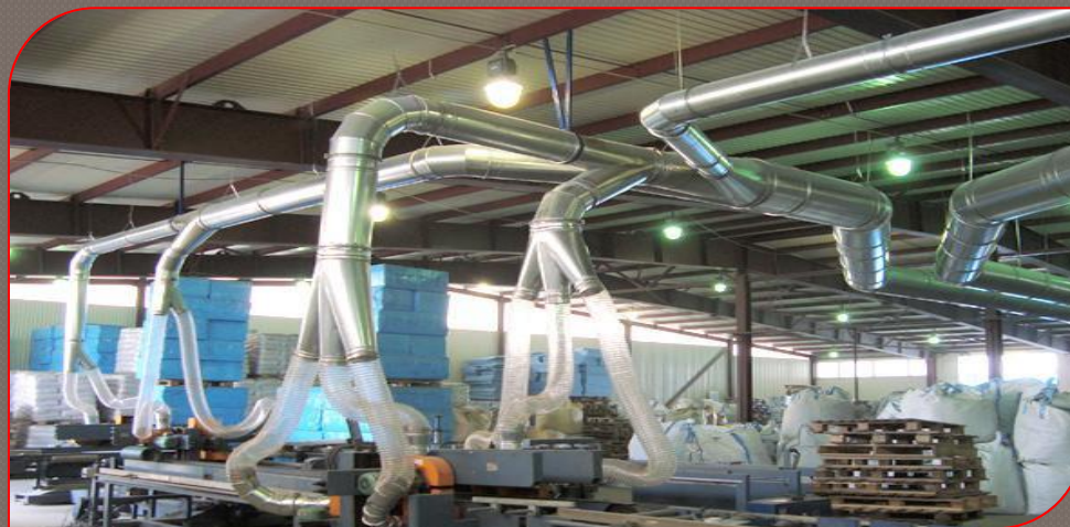
Вентиляция хлебопекарного цеха
