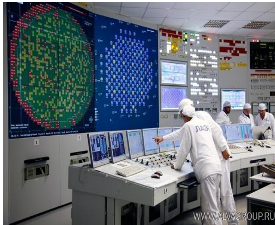
Ленинградская АЭС. Блочный щит управления
