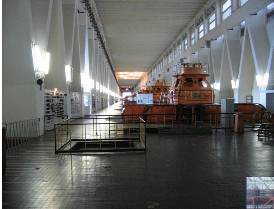
Машинный зал Братской ГЭС
