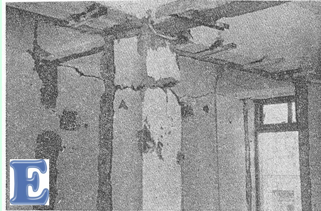
Рис. 2.2. Повреждение монолитной железобетонной колонны первого каркасного этажа пятиэтажного жилого дома в Буйнакске (расчетная сейсмичность 7 баллов)
