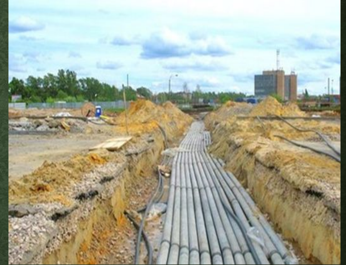
Волоконно-оптическая линия связи
