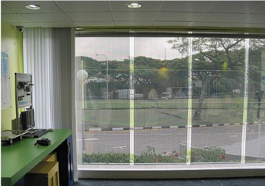
ВРV-остекление, использованы тонкопленочные модули большой прозрачности
