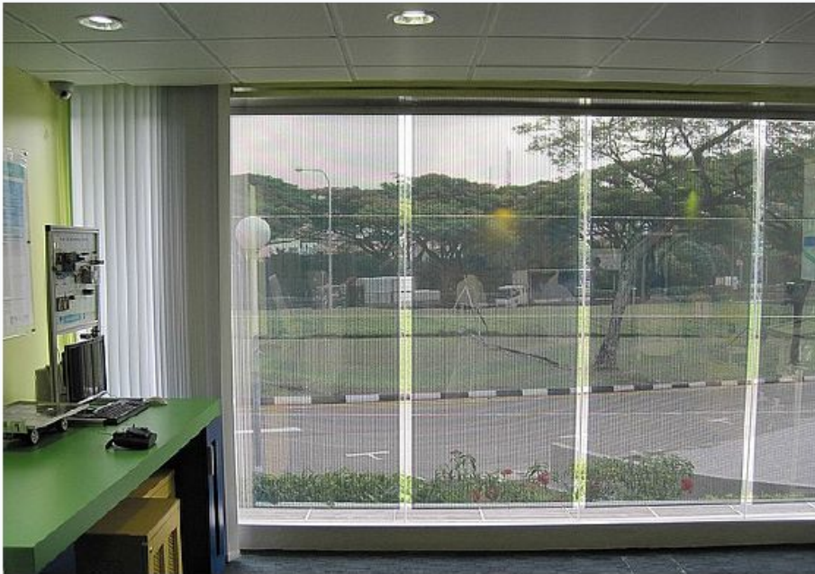
ВРV-остекление, использованы тонкопленочные модули большой прозрачности
