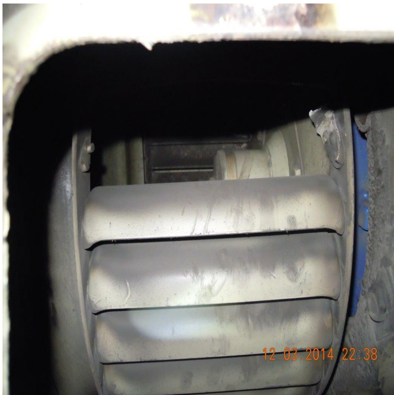
Электродвигатель вентилятора охлаждения ТЭД 4АЖ225М602
