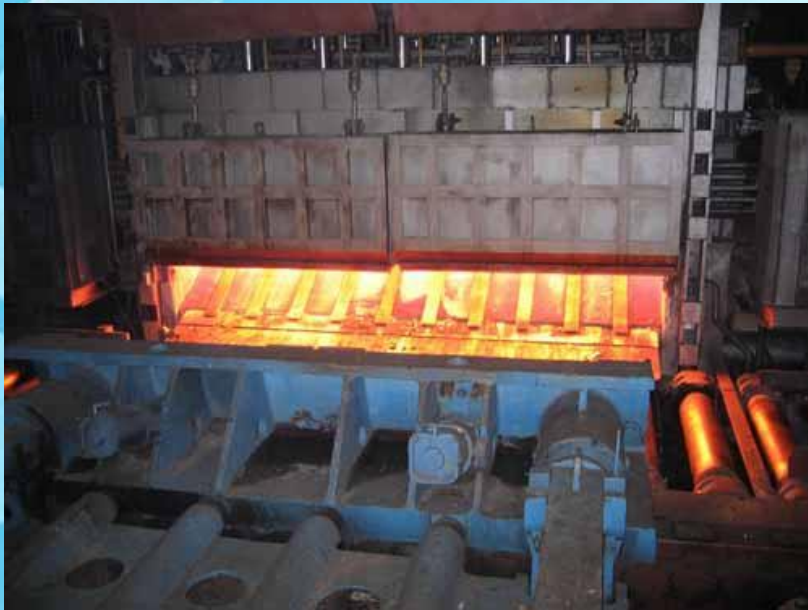
Методическая нагревательная печь № 3 в ЛПЦ-1 ОАО «Северсталь» (г. Череповец), реконструированная фирмой ЗАО «ТЕРМОСТАЛЬ», Россия
