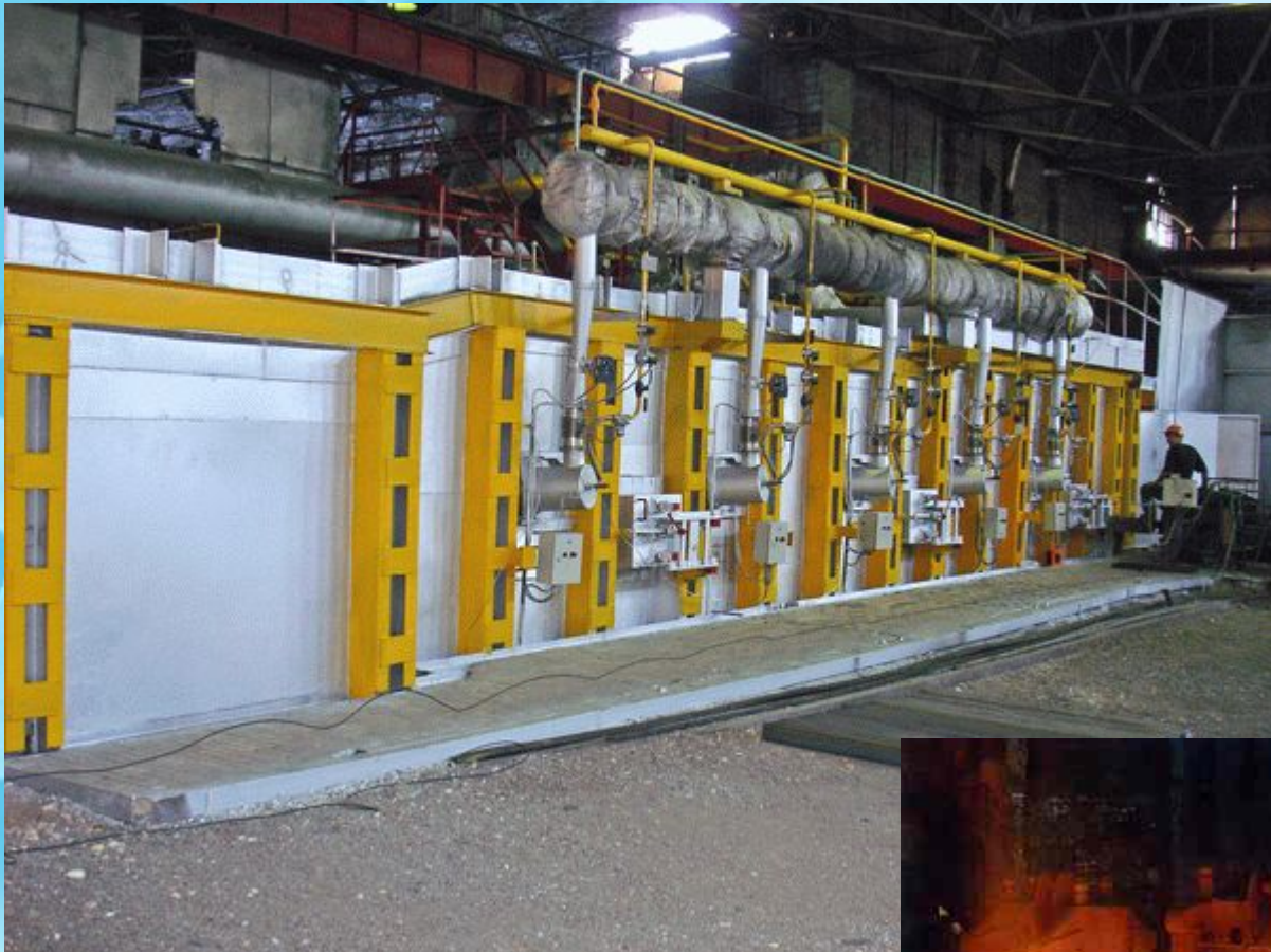
Методическая печь прокатного стана с газовыми горелками ГСП-120. Изготовитель - ЗАО «КОМАС» («Комплексные автоматизированные системы»), Россия
