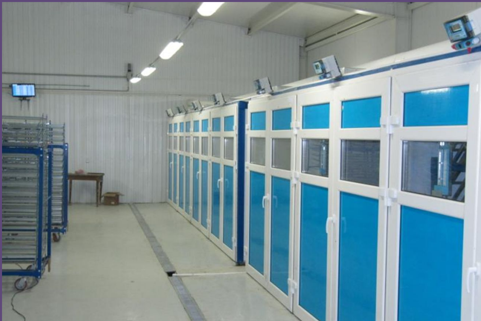
Камеры инкубатора с новой автоматикой
