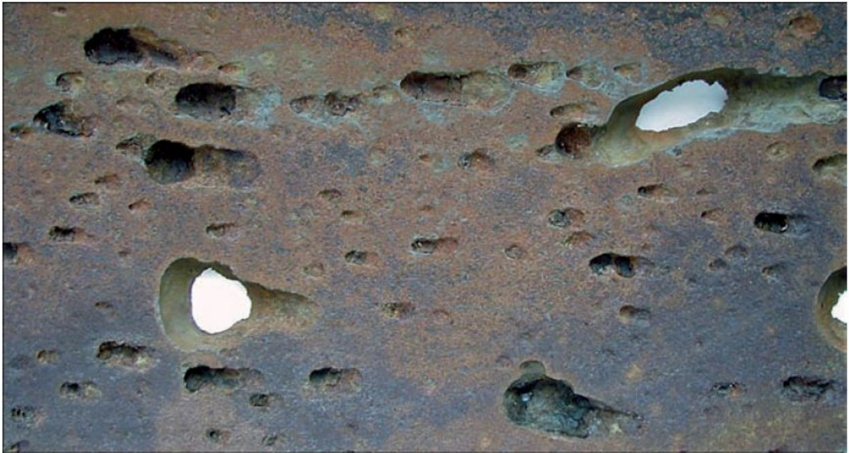
Рис. Язвенная коррозия нижней образующей трубопровода ( \varnothing 426 \times 8 мм) ССН. Язвы вытянуты по направлению потока жидкости. Канавка не успела образоваться, так как развитие язв вглубь металла происходило быстрее, чем по поверхности трубопровода (г. Радужный, Нижневартовский район, 1995 г.)
