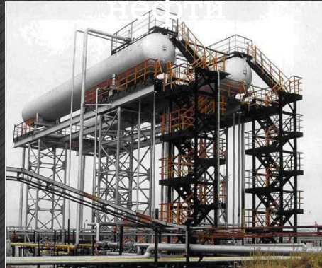
Установка подготовки нефти
