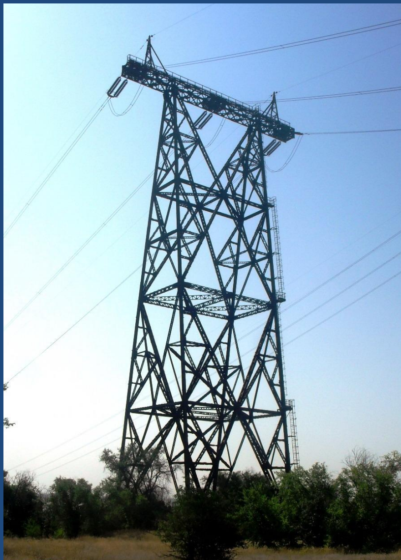
Переход ВЛ 220кВ через Волгу
