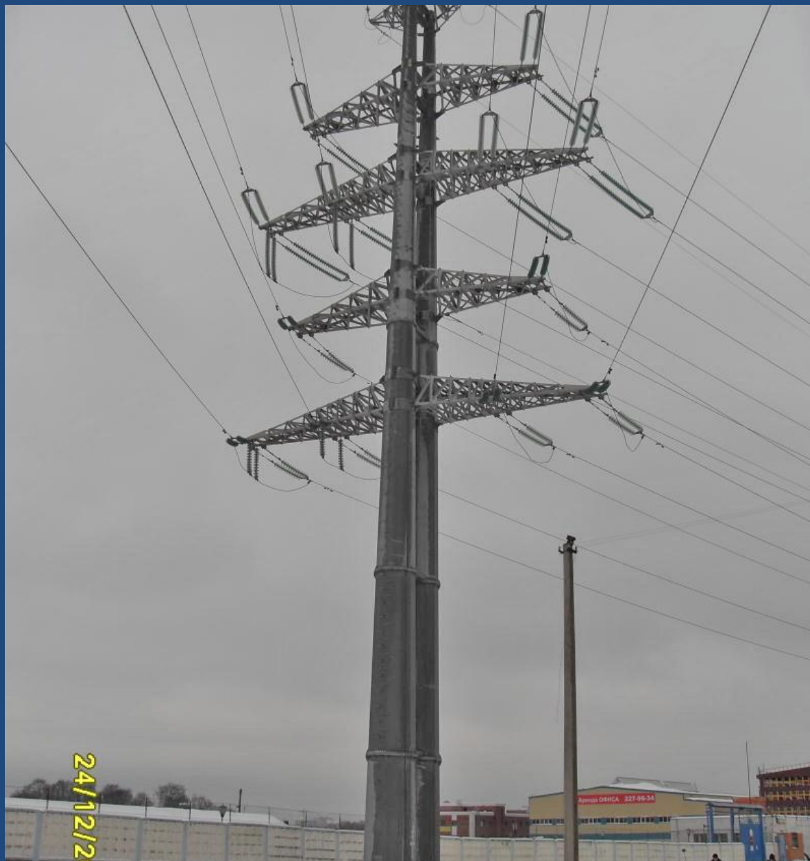
Анкерно-угловая опора МКО ВЛ220кВ
