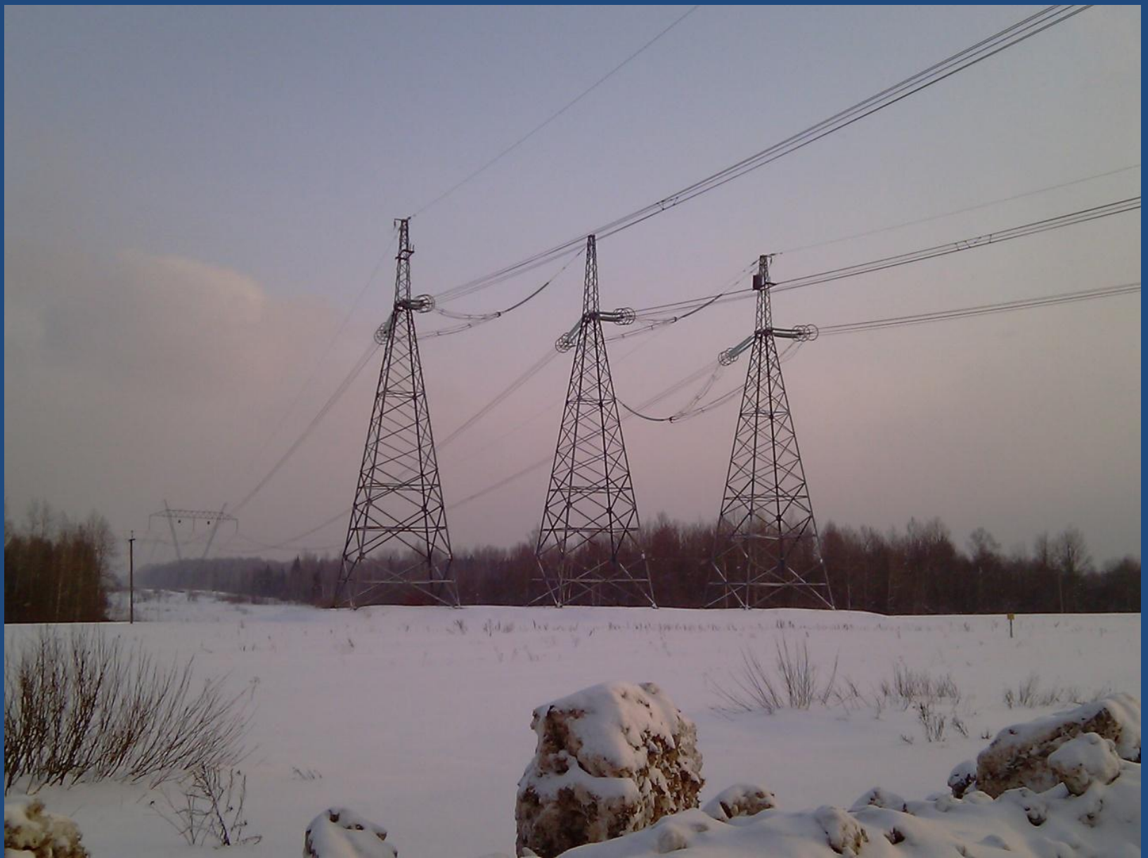
ВЛ 750кВ ЛАЭС - Центр (переход через трассу СПб-Москва)
