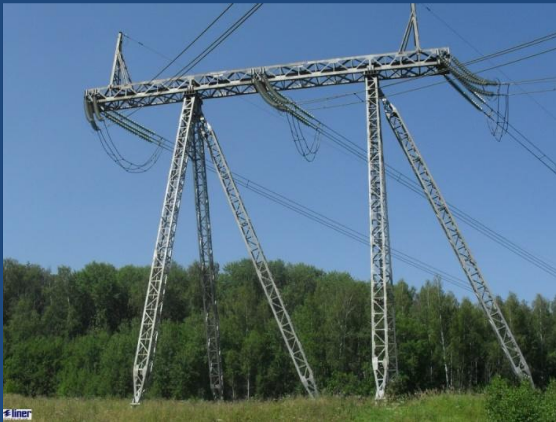
Анкерно-угловая опора ВЛ 500кВ
