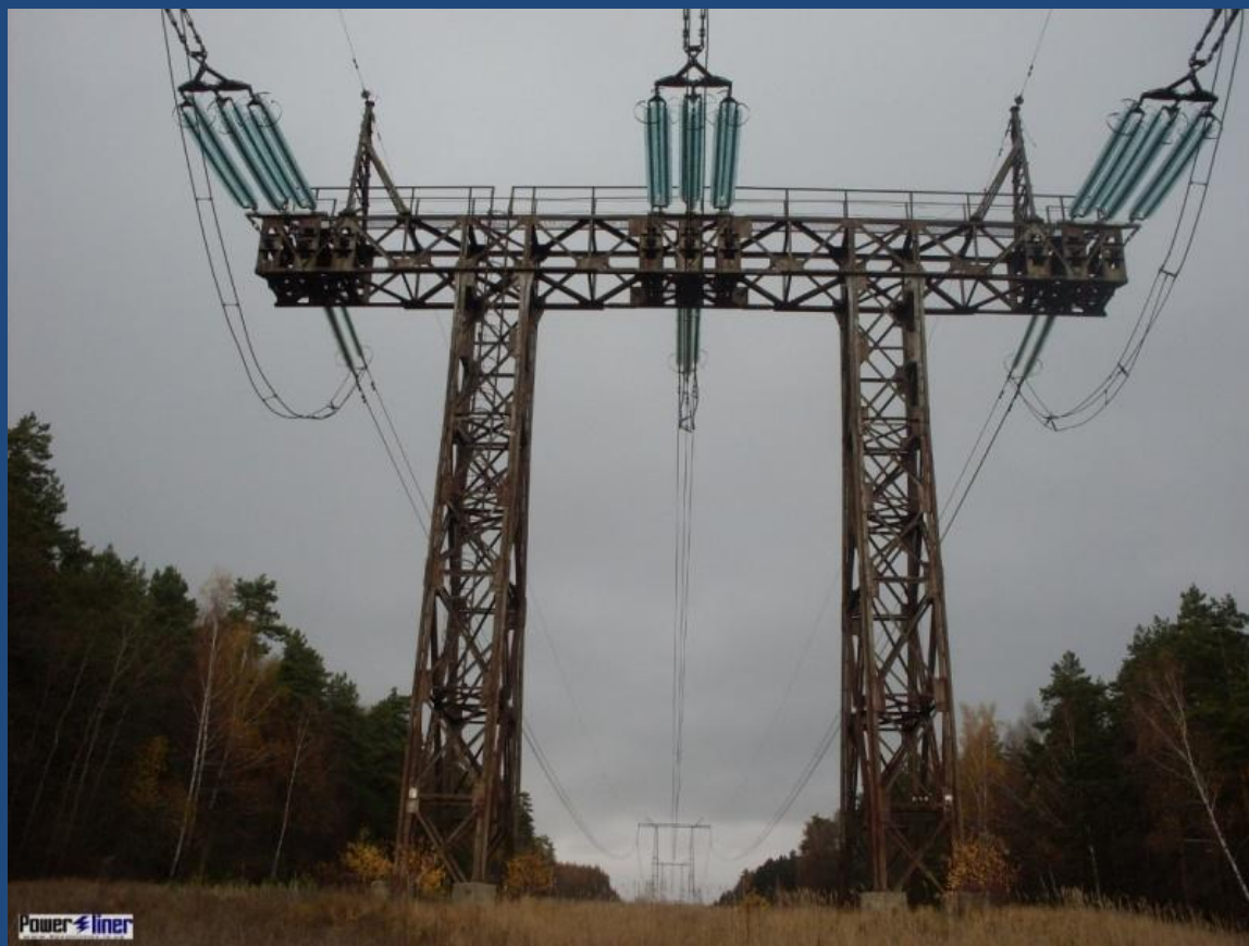
Переход ВЛ 500кВ через Волгу
