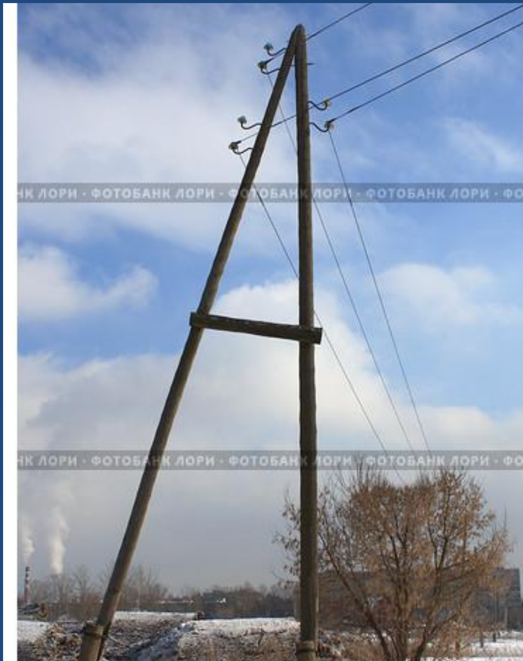
Деревянная опора линии электропередачи © АЛЕКСАНДР МИХЕИЧЕВ / Фотобанк Лори
