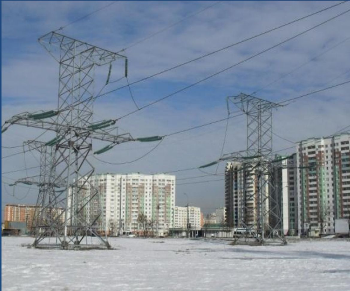
2 цепи ВЛ220кВ с грозозащитными тросами
