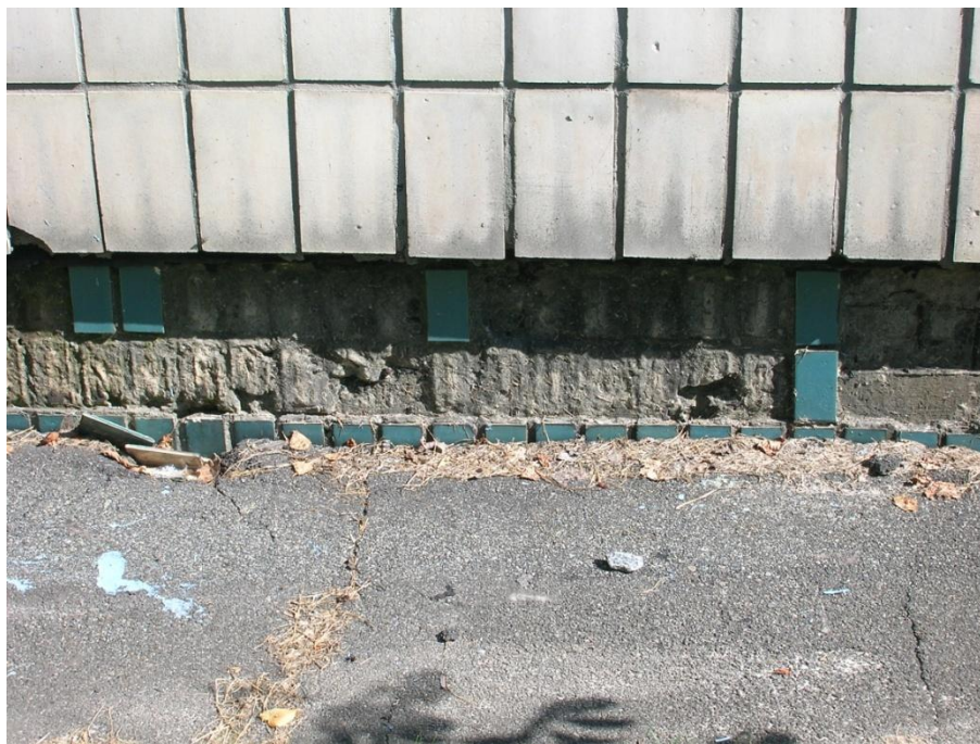
Рис. 3. Фрагмент пошкодження облицювання цоколя споруди та відмостки
