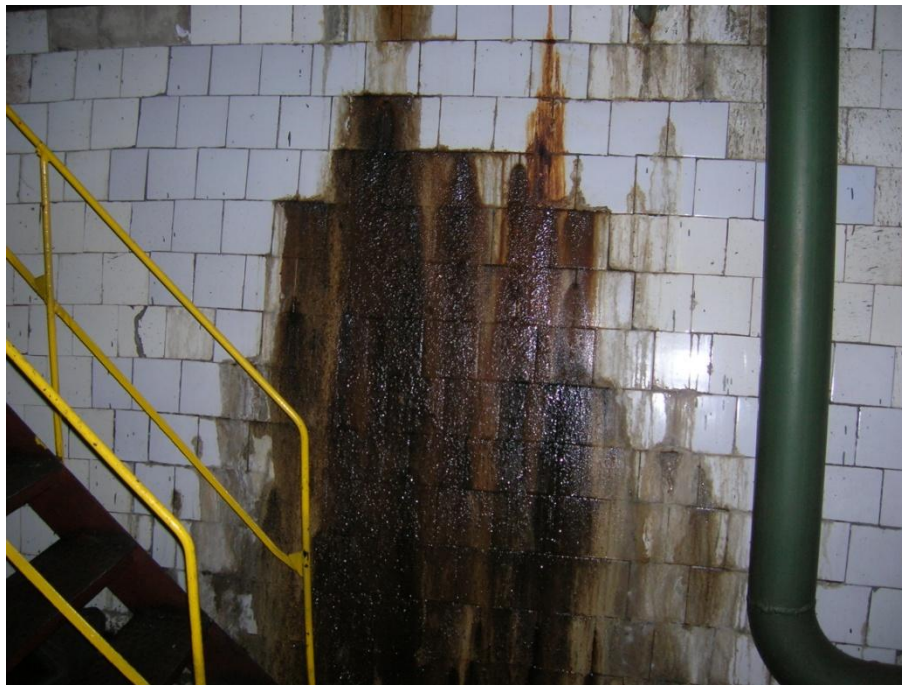
Рис. 4. Фрагмент просочення ґрунтових вод, біля підніжжя циліндричних зовнішніх стін.
