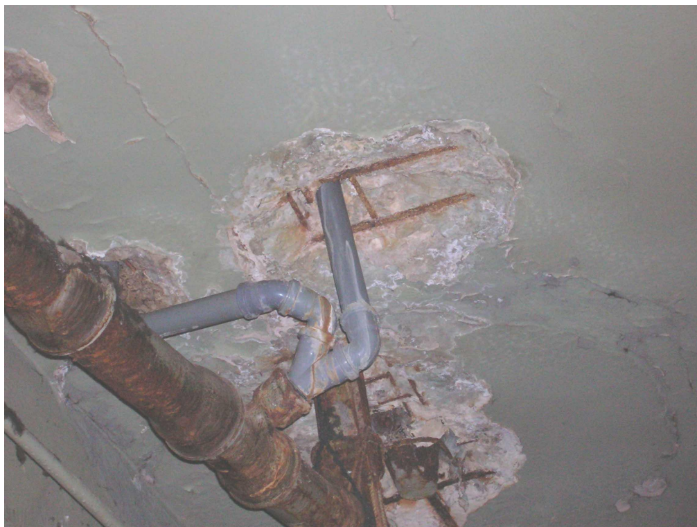
Рис. 5. Пошкодження плити перекриття внаслідок прокладання труб для водовідведення з побутових приміщень
