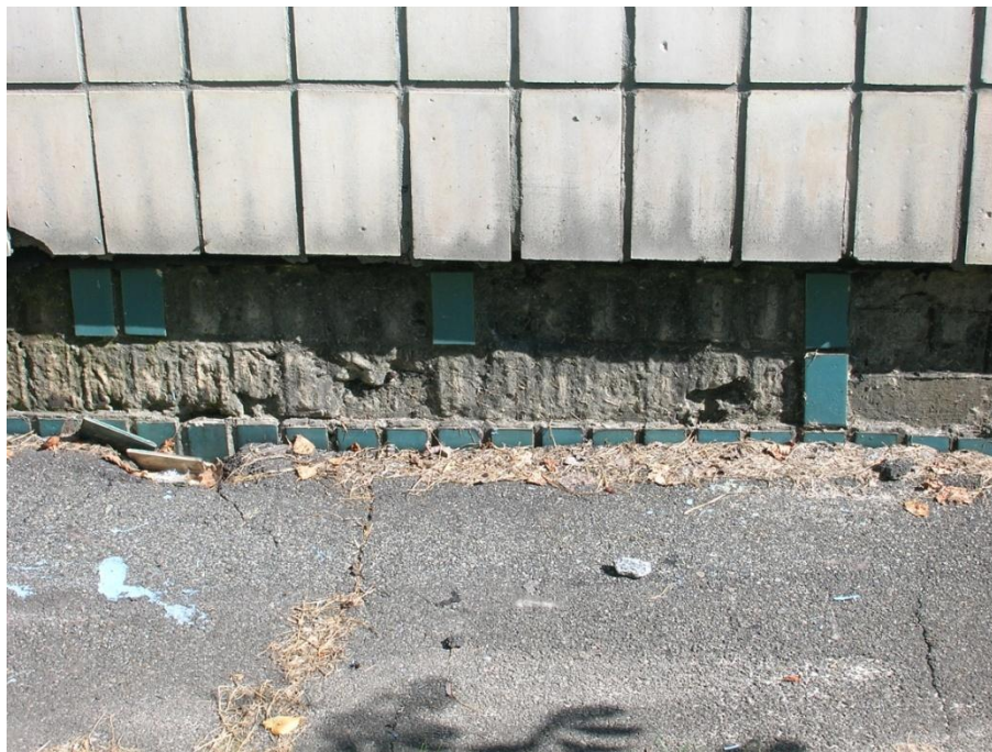
Рис. 3. Фрагмент пошкодження облицювання цоколя споруди та відмостки
