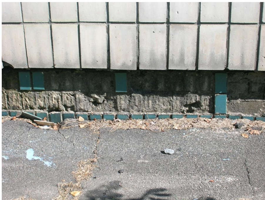
Рис. 3. Фрагмент пошкодження облицювання цоколя споруди та відмостки
