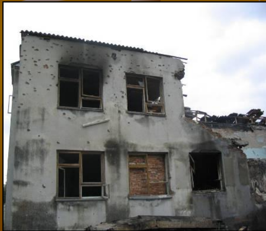
Школа, разрушенная в ходе теракта.
