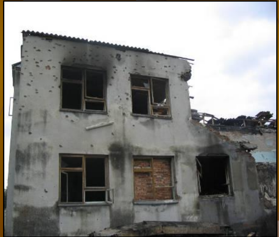
Школа, разрушенная в ходе теракта.
