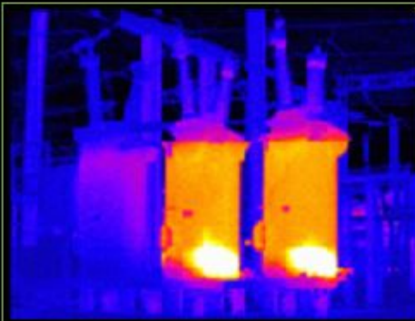
Нарушение в работе системы обогрева
