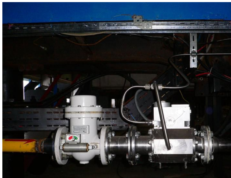
Отсечной клапан 816.СКВБ-01 (г.Волчанск) с функцией дренирования участка трубопровода после себя, фильтр ФГ-16 (г.Саратов)
