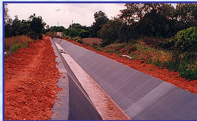
Канал с пленочным покрытием
