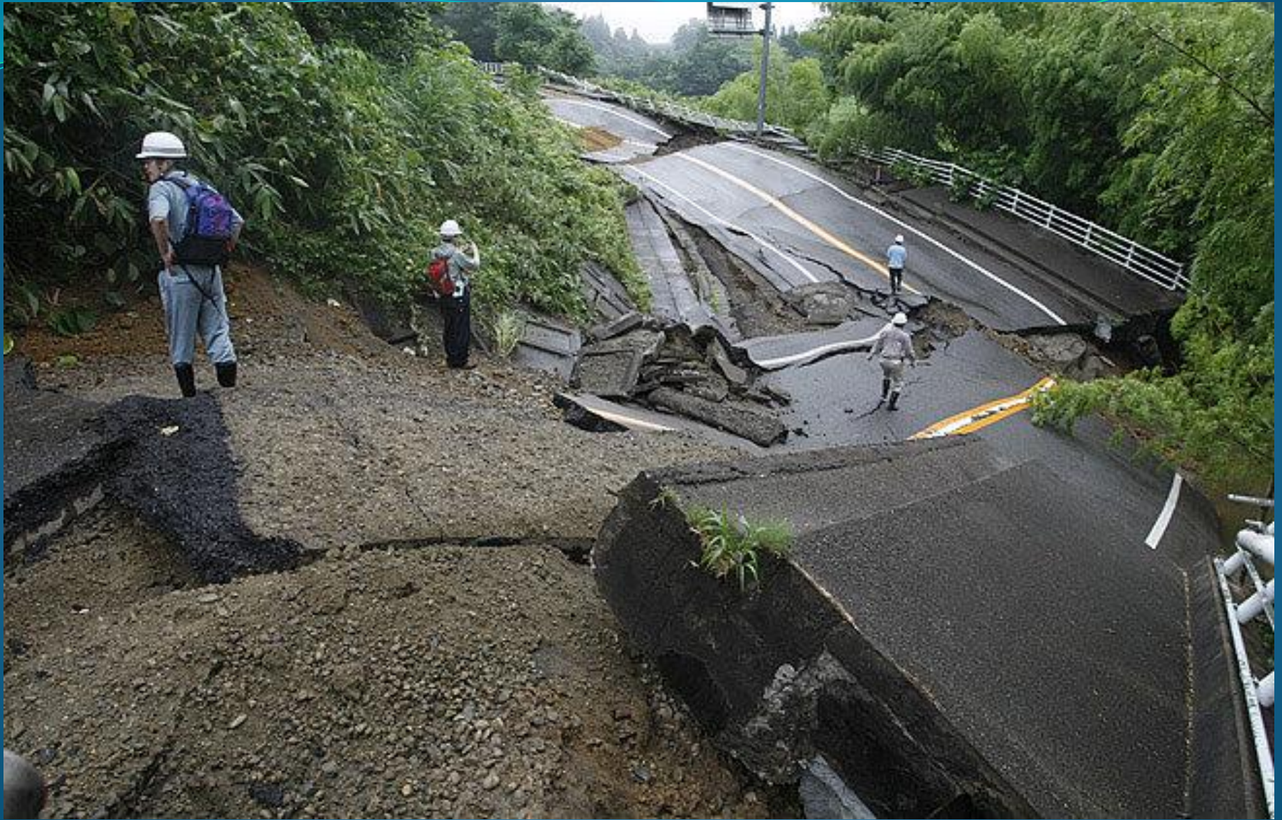
Смещение плит при землетрясениях
