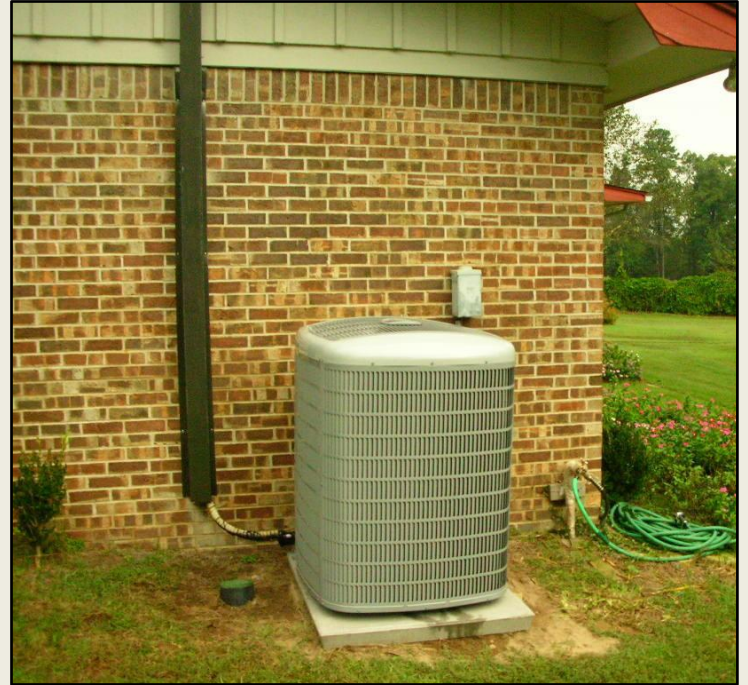
Фото. 6. Вид наружного блока ТН.
