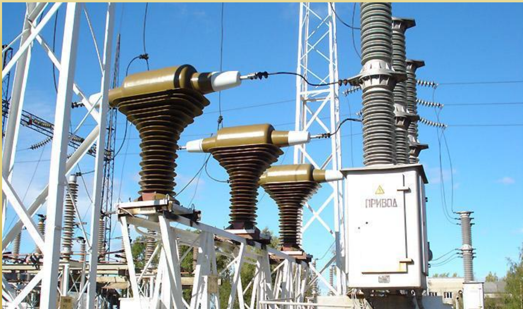
Опорный трансформатор тока ТОЛ-110
