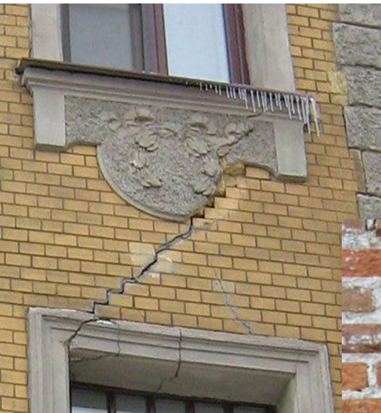
Примеры частичного разрушения кирпичной кладки
