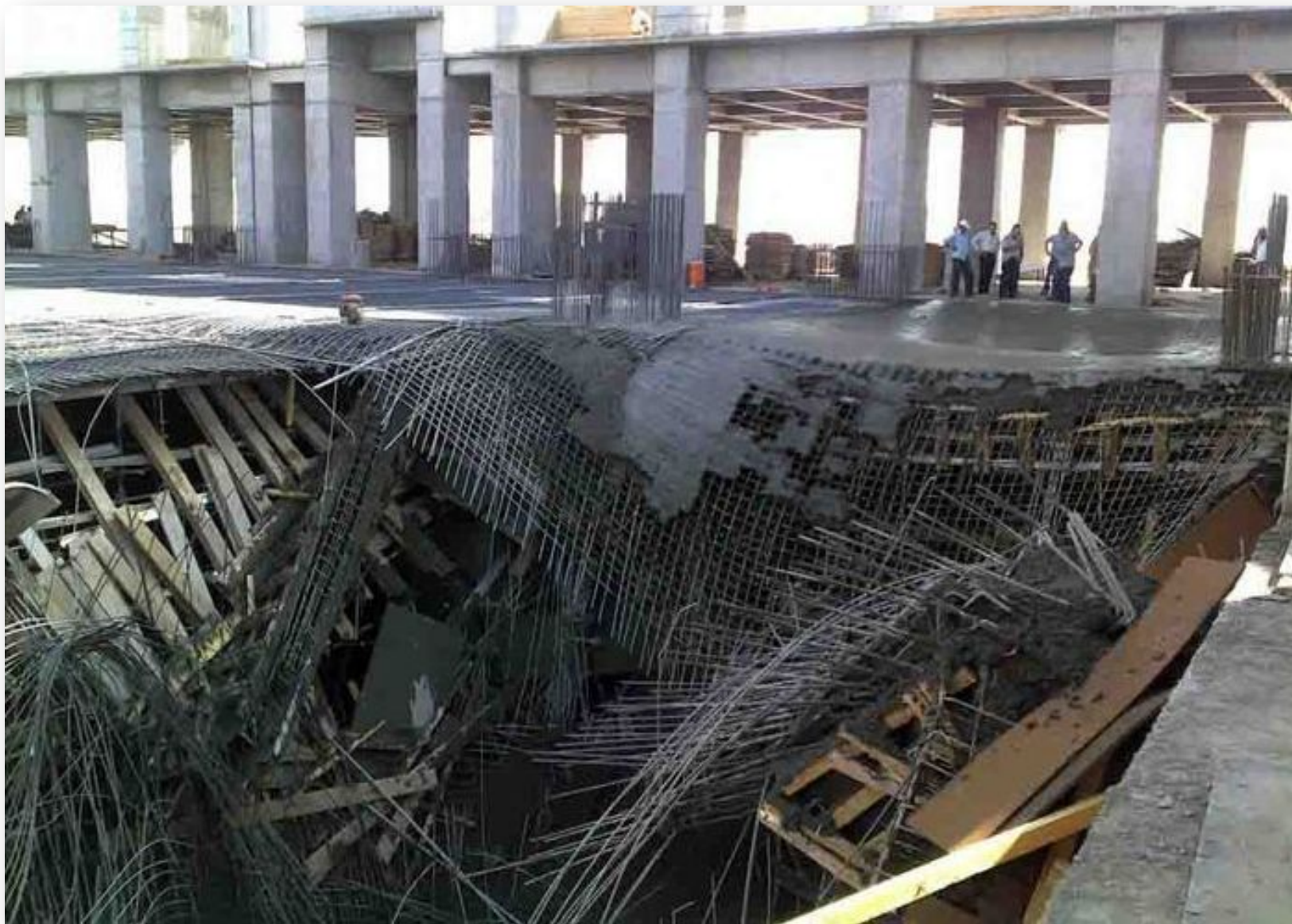
Обрушение монолитного перекрытия
