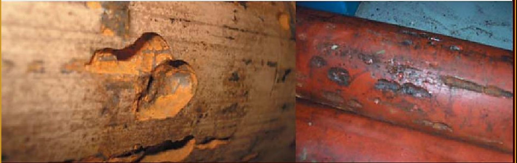
Питтинговая (язвенная коррозия)
